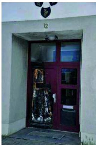
Tür des Verbindungshauses nach der Brandstiftung
